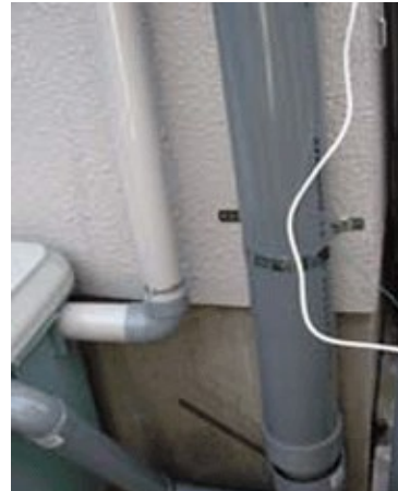
右側の壁に固定のパイプは初期雨水分離槽100φ、隣が沈殿槽へ雨水を送るパイプ、手前が満水排水管
