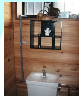
トイレタンクに既設との併用給水
