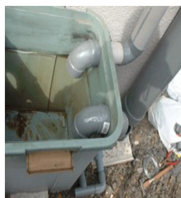
沈澱槽内部 奥の配管は雨水取り込み配管 手前はオーバーフローの配管です。
