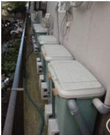
一番手前が沈殿槽、次から5個は貯水槽の計6個設置してあります 使用できる貯水量は0.5tです
